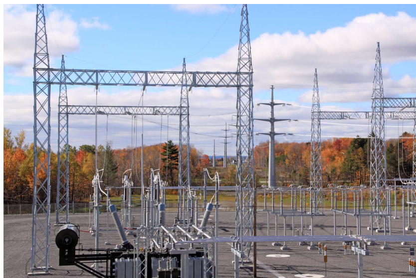
Exemple de poste à 315 kV
